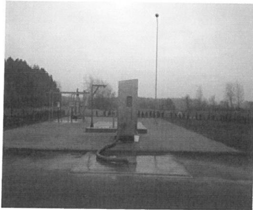
1. Punkt zlewny ścieków dowożonych taborem asenizacyjnym
